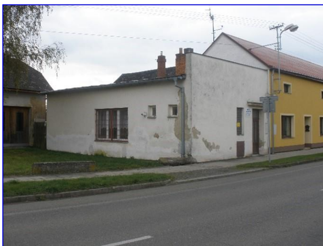
Foto č. 12 - Fasáda před opravou v roce 2012
